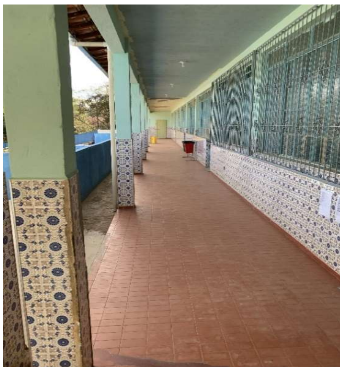
Figura 3. Corredor do bloco 1 sem qualquer sistema de prevenção
