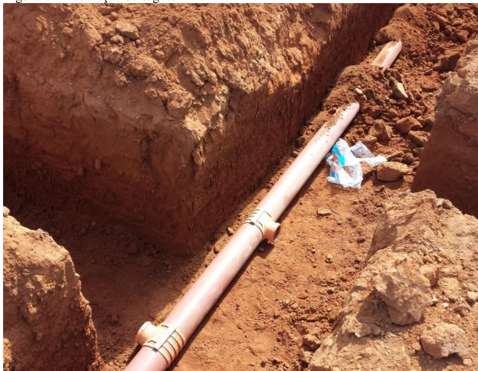
Figura 7 – Tubulação de esgoto
