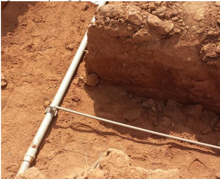
Figura 8 – Tubulação de água potável
