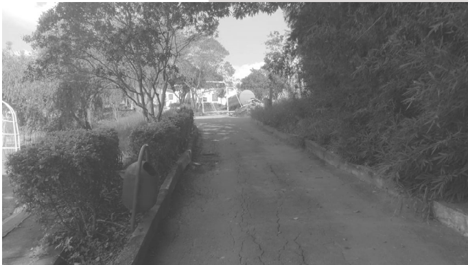
[43]: Asfalto deteriorado, dificultando a acessibilidade
