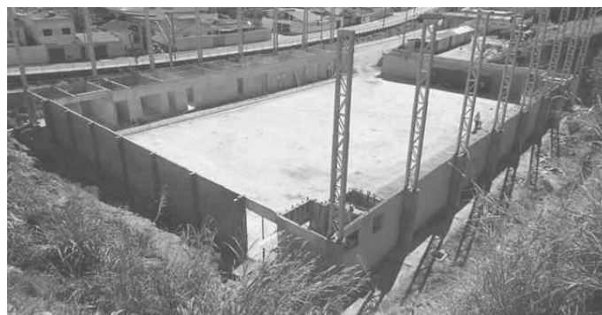
Figura 14 - Obra CIE Varginha abandonada
