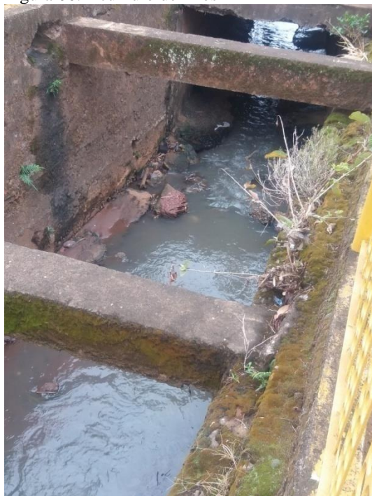
Figura 06. Acúmulo de lixos
