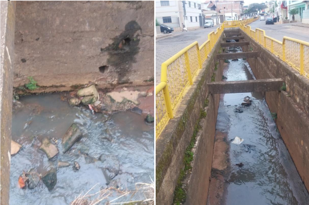
Figura 05. Erosão no Fundo do Canal
