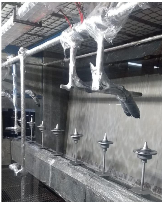
Figura 12: Interior da cabine de pintura após alteração
