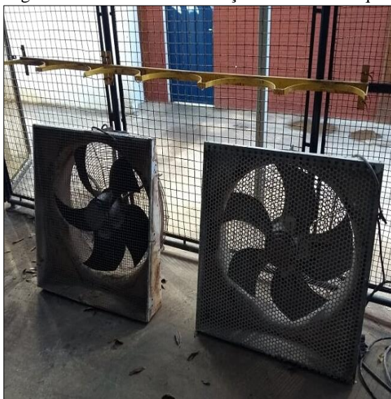
Figura 21 - Sistema de ventilação da sala de máquinas
