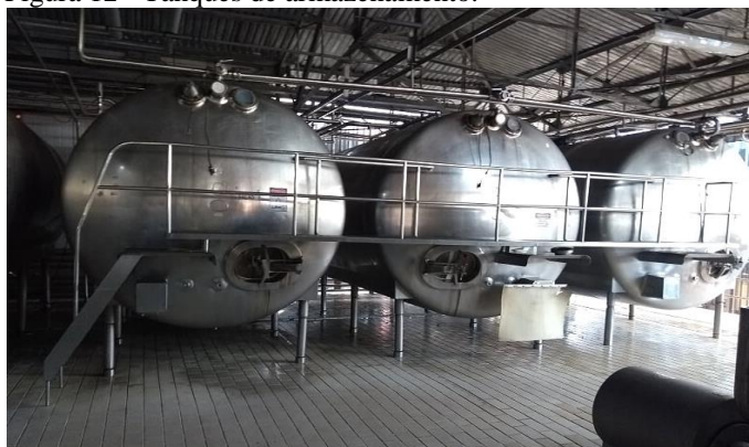
Figura 12 - Tanques de armazenamento.
