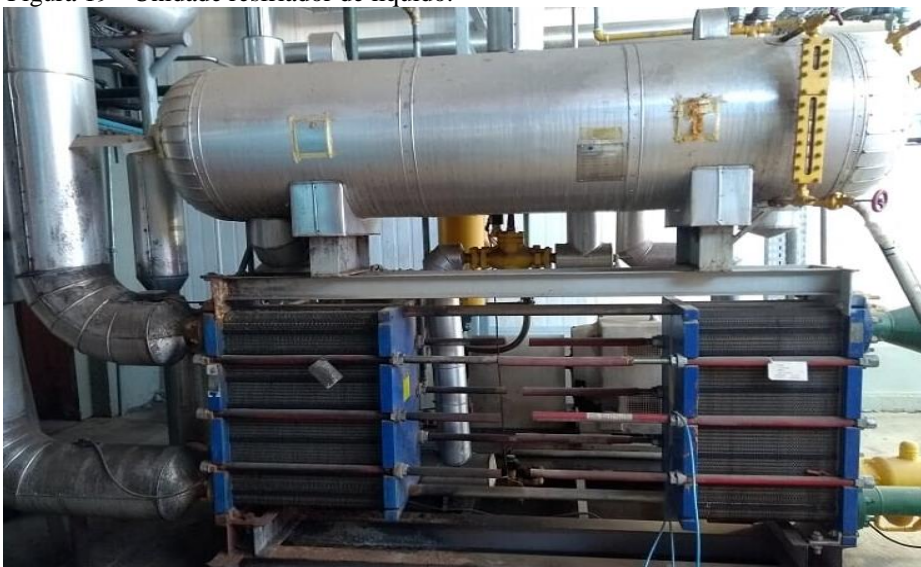
Figura 19 - Unidade resfriador de líquido.
