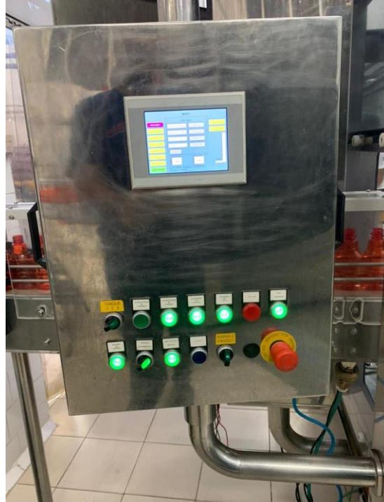
Figura 5: Painel de controle envasadora, dispositivo CLP
