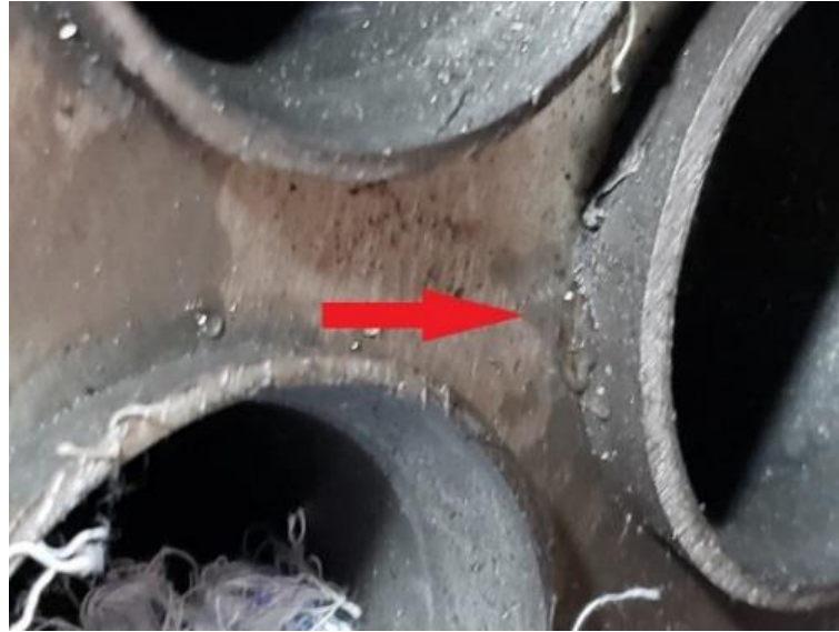
Figura 13: Vazamentos presentes no tubo
