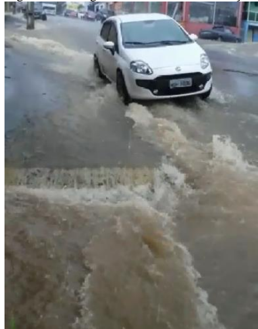
Figura 08 – Alagamento na saída da tubulação
