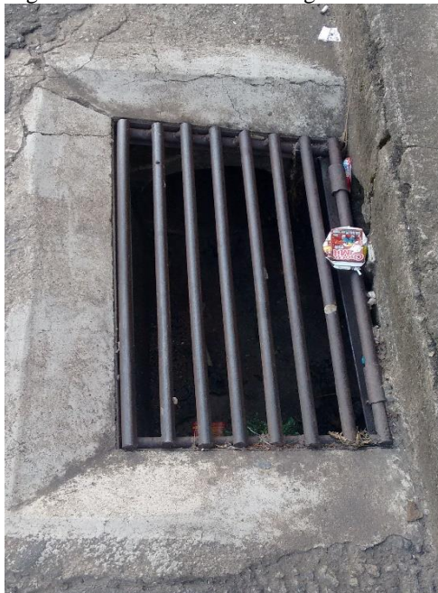
Figura 03 – Boca de lobo com grelha
