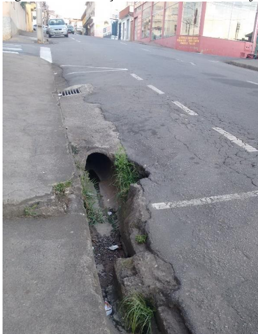
Figura 07 – Tubulação secundária sobre a sarjeta
