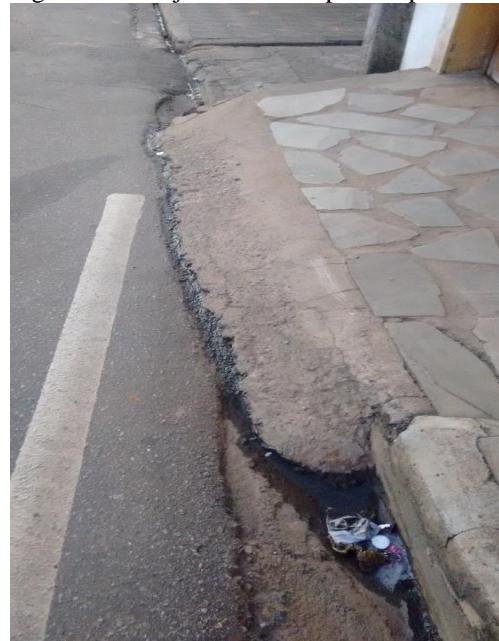
Figura 06 – Sarjeta obstruída por rampa
