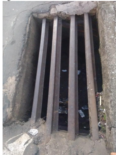
Figura 04 – Boca de lobo com trilhos de ferro
