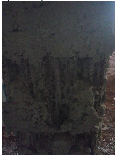
Figura 4.9: Vazios e segregação dos agregados provocados pelo excesso de armadura.
