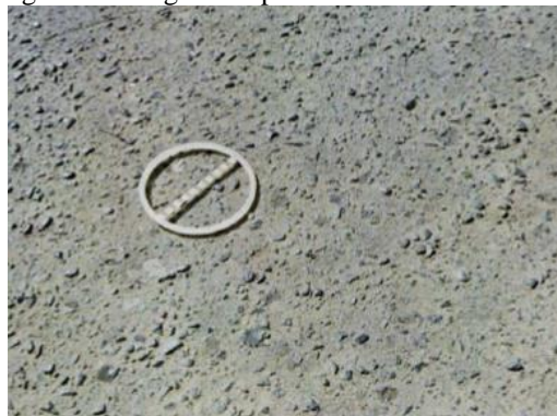
Figura 14- Desgaste do pavimento
