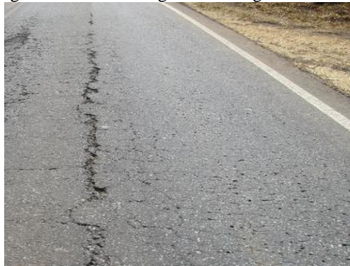
Figura 20- Trincas Longitudinais longas
