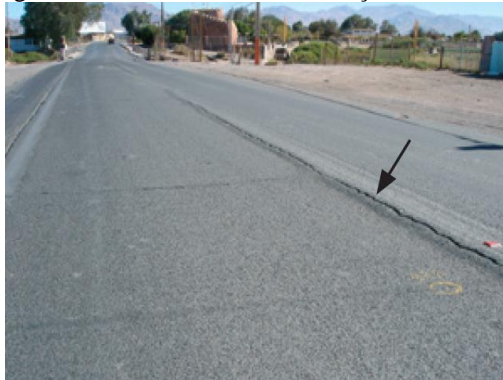
Figura 18- Trincas Isoladas de Retração
