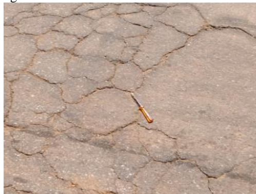
Figura 19- Trincas em Blocos
