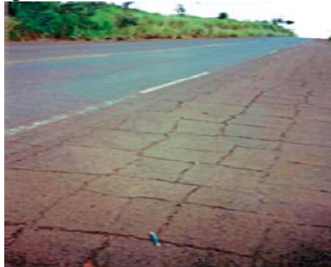
Figura 17- Fissuras e trinca
