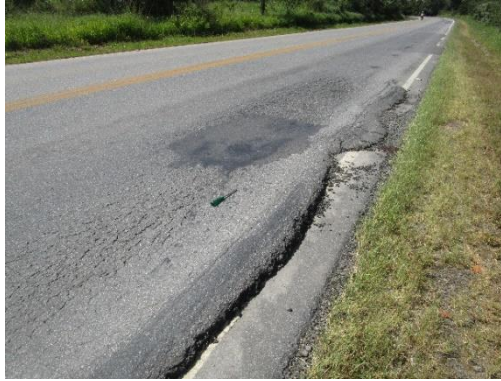
Figura 16- Escorregamento de massa asfáltica
