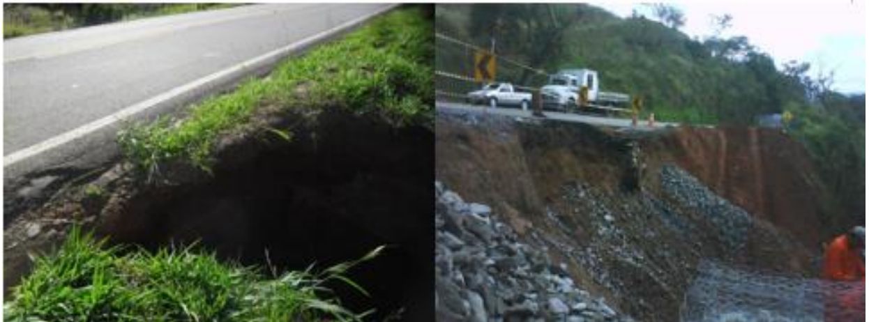
Figura 8- Erosão na via
