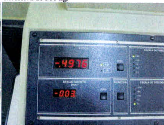
Figura 17 - Painel de controle indicando a carga excessiva de 500 kg.
