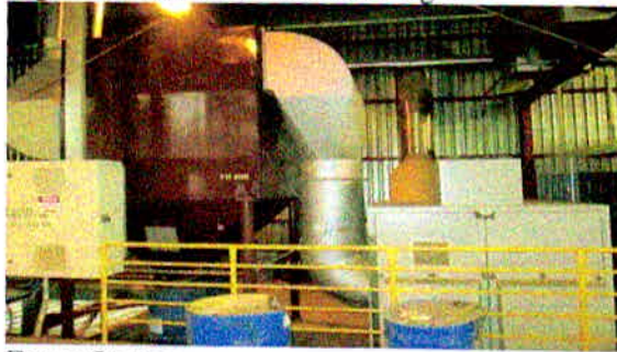
Figura 12: Sistema de exaustão de gases.
