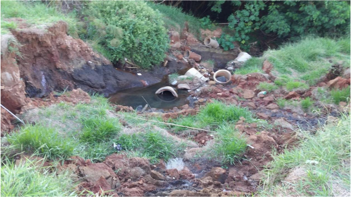
Figura 37 – Local do rompimento da galeria.
