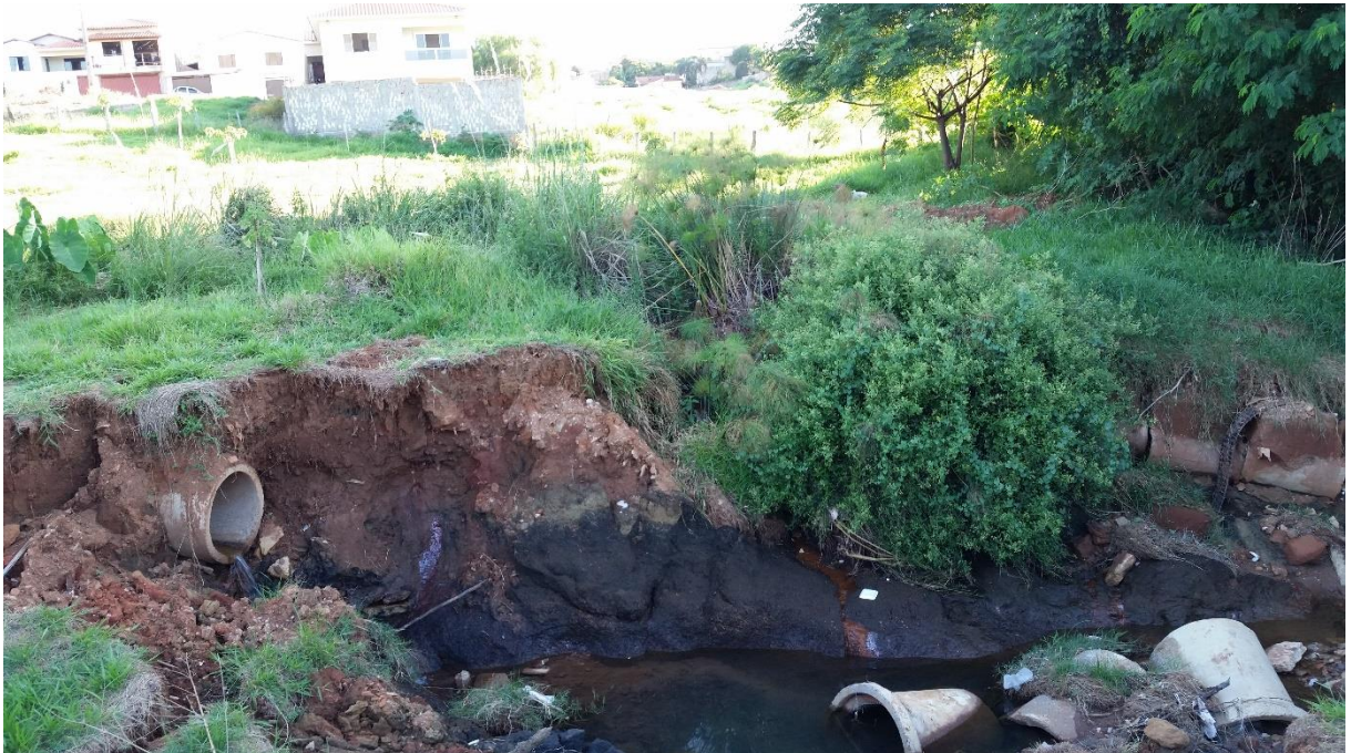
Figura 22 – Local de rompimento da galeria.
