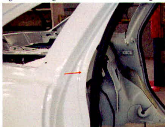
Figura 11 – Fotografia de uma das ocorrências registradas na montagem da vedação
