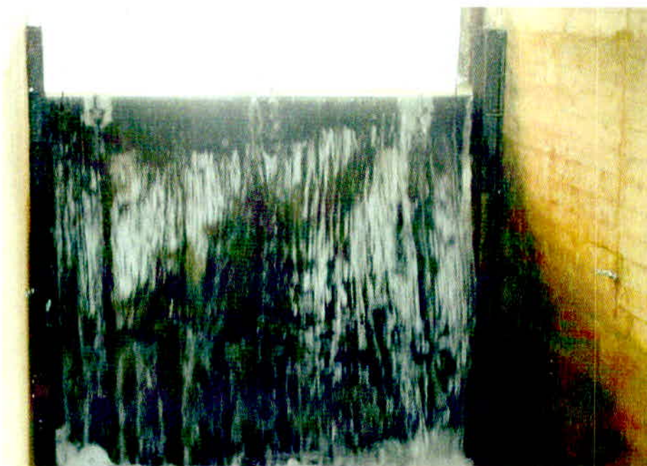
Figura 28 – Comporta sendo Fechada Fonte: Autor
