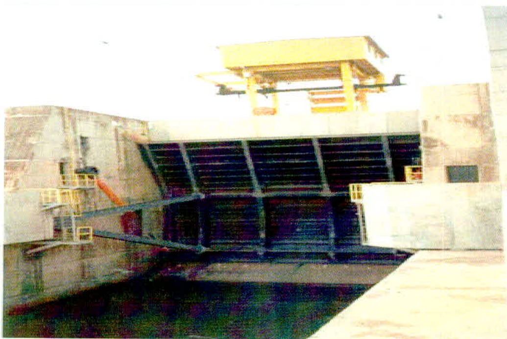
Figura 1: Exemplo de Tabuleiro de Comportas Fonte: Autor
