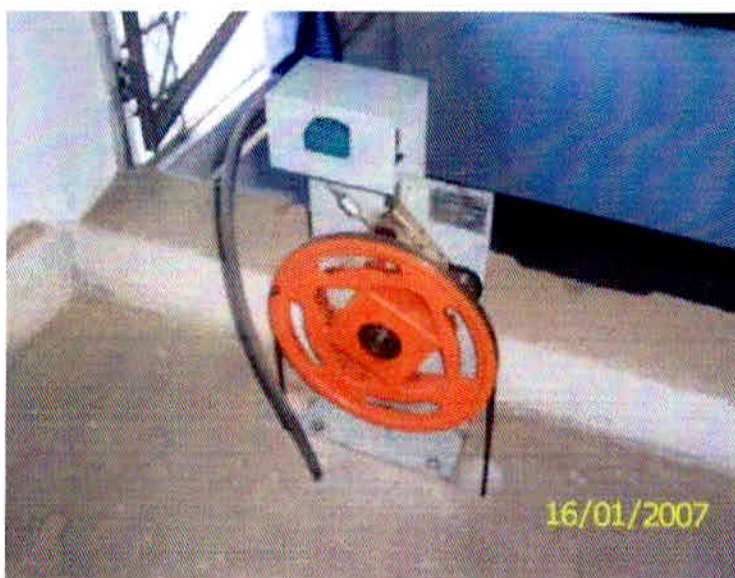
Figura 6: Limitador de velocidade, vista lateral.
