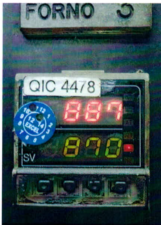
Figura 3 - Painel indicador de temperatura do Forno 3.
