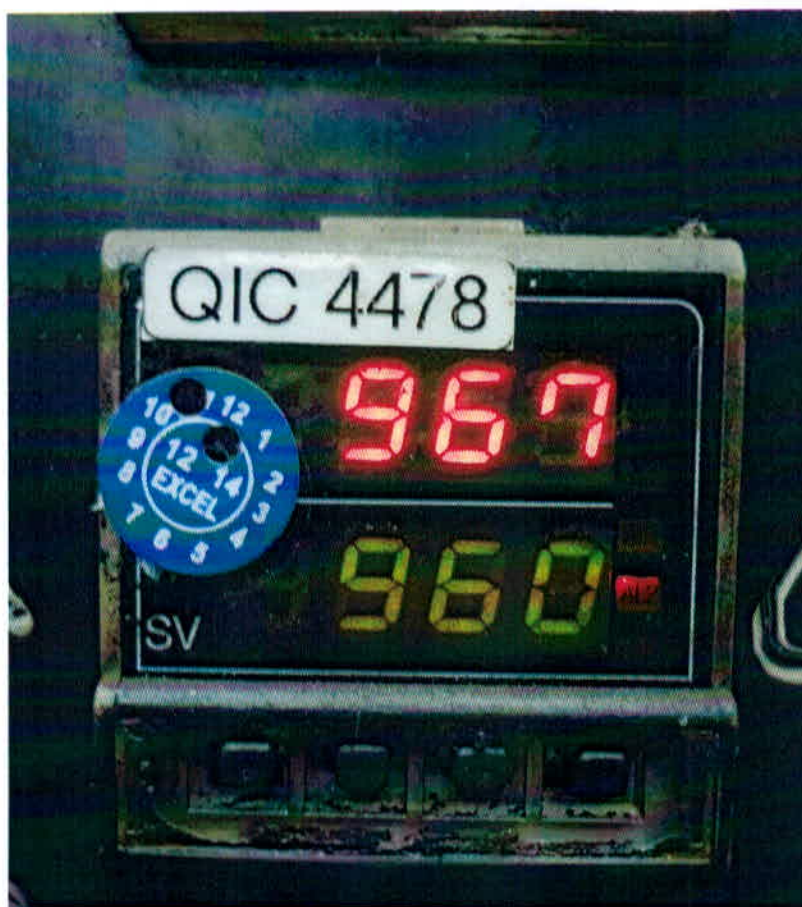
Figura 6 - Painel indicador de temperatura do Forno 3.
