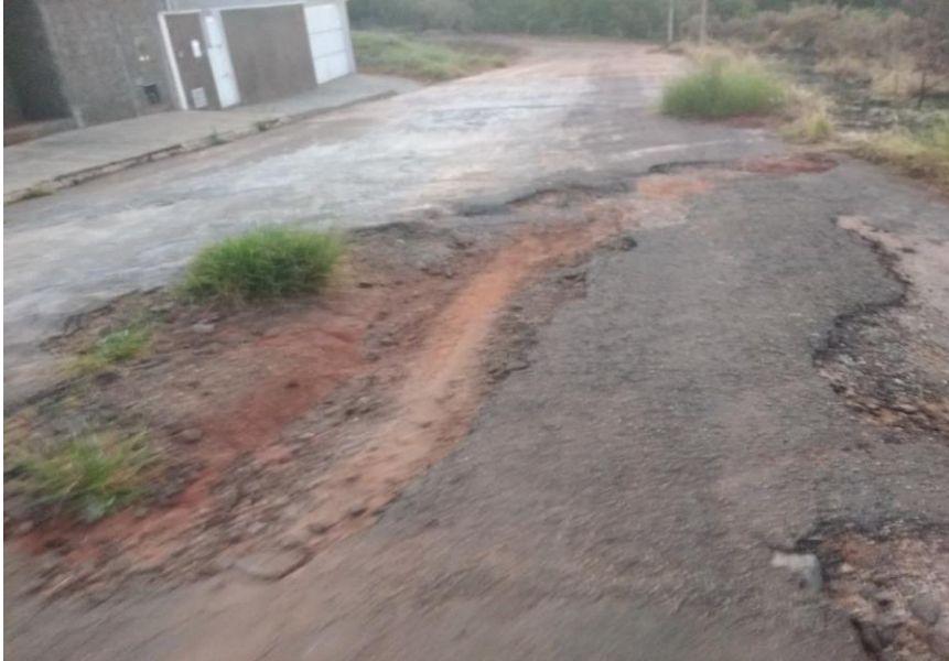
Figura 347 - Patologias no bairro Jardim das Magnólias
