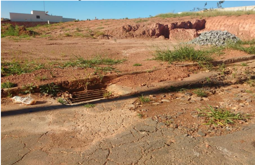
Figura 358 - Boca de lobo - Bairro Morada do Sol
