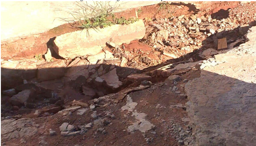
Figura 34 - Patologias na Avenida Capitão Reis
