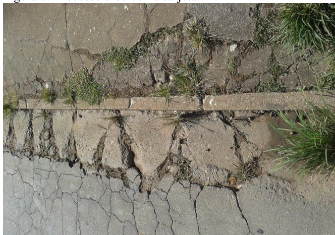
Figura 7: Processo erosivo na sarjeta.
