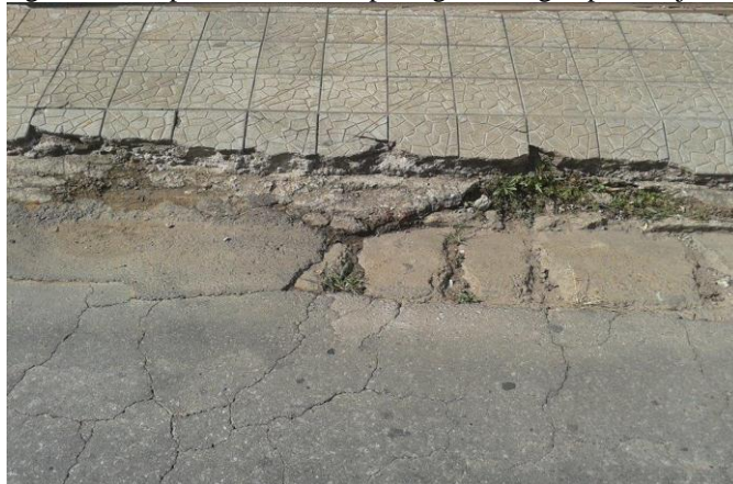
Figura 8: Rampas obstruindo a passagem de água pela sarjeta.
