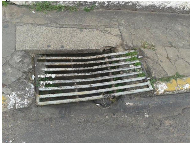
Figura 9: Estado estrutural da boca-de-lobo.
