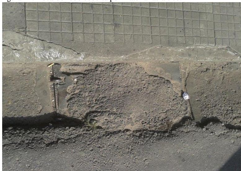
Figura 12: Boca-de-lobo coberta por material asfáltico.
