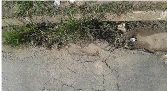
Figura 6: Vegetação impedindo o escoamento das águas pelas sarjetas.
