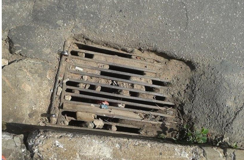
Figura 13: Boca-de-lobo afetada por material asfáltico.
