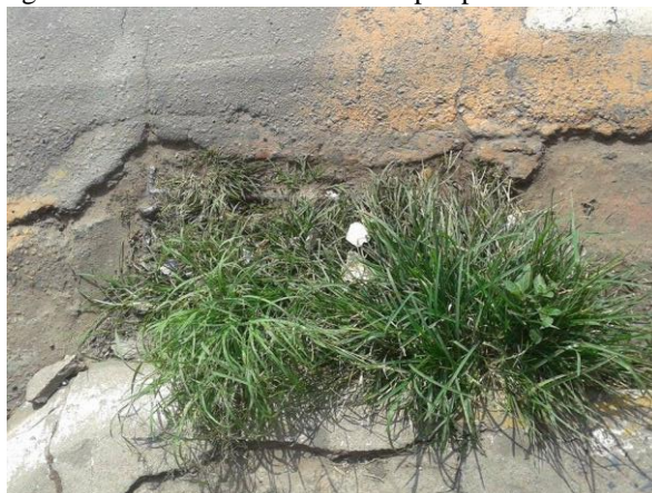
Figura 10: Boca-de-lobo obstruída por plantas.
