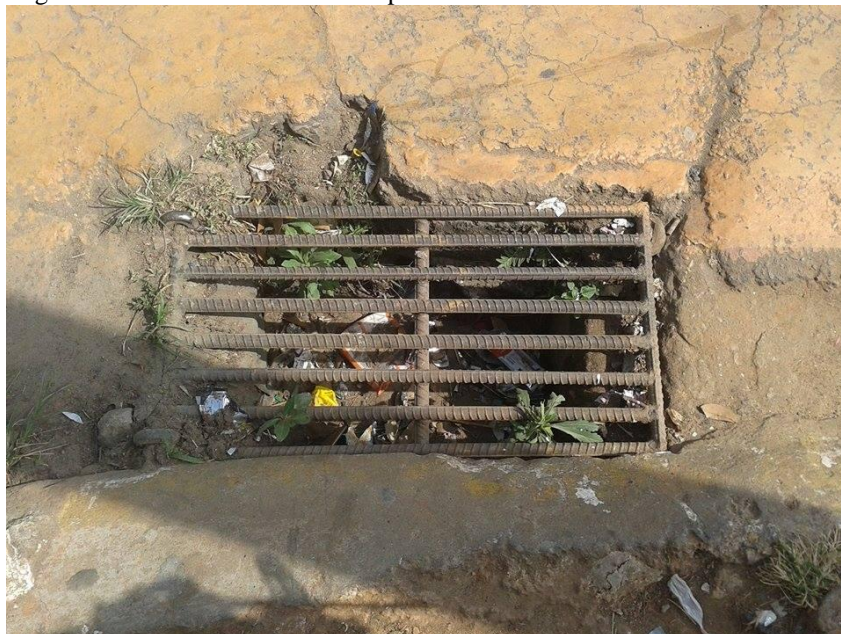
Figura 11: Boca-de-lobo obstruída por lixos.
