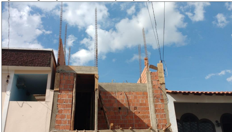
Figura 6 - Segundo pavimento sem bandejas de proteção.
