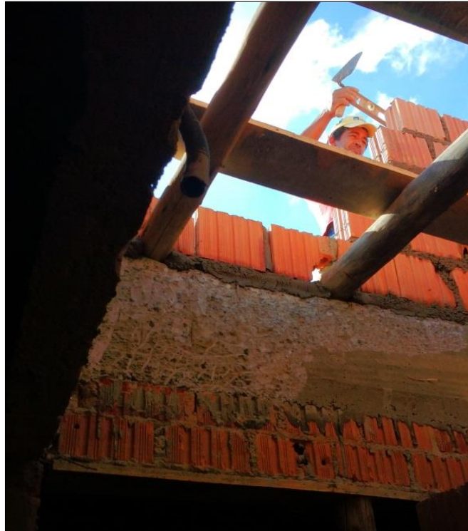
Figura 9- Trabalho sem proteção no segundo pavimento.
