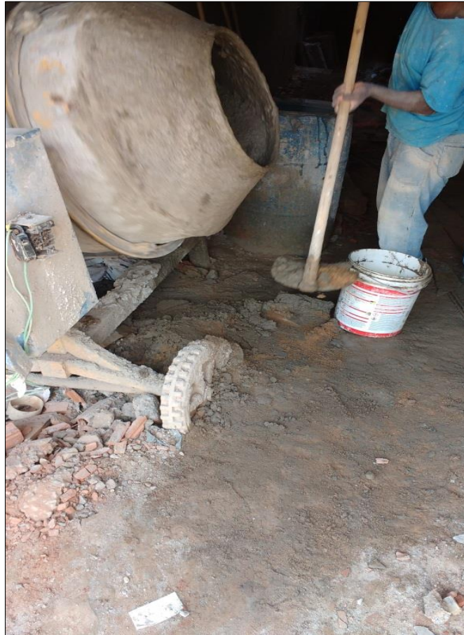
Figura 7 - Utilização de maquinário de forma inadequada.
