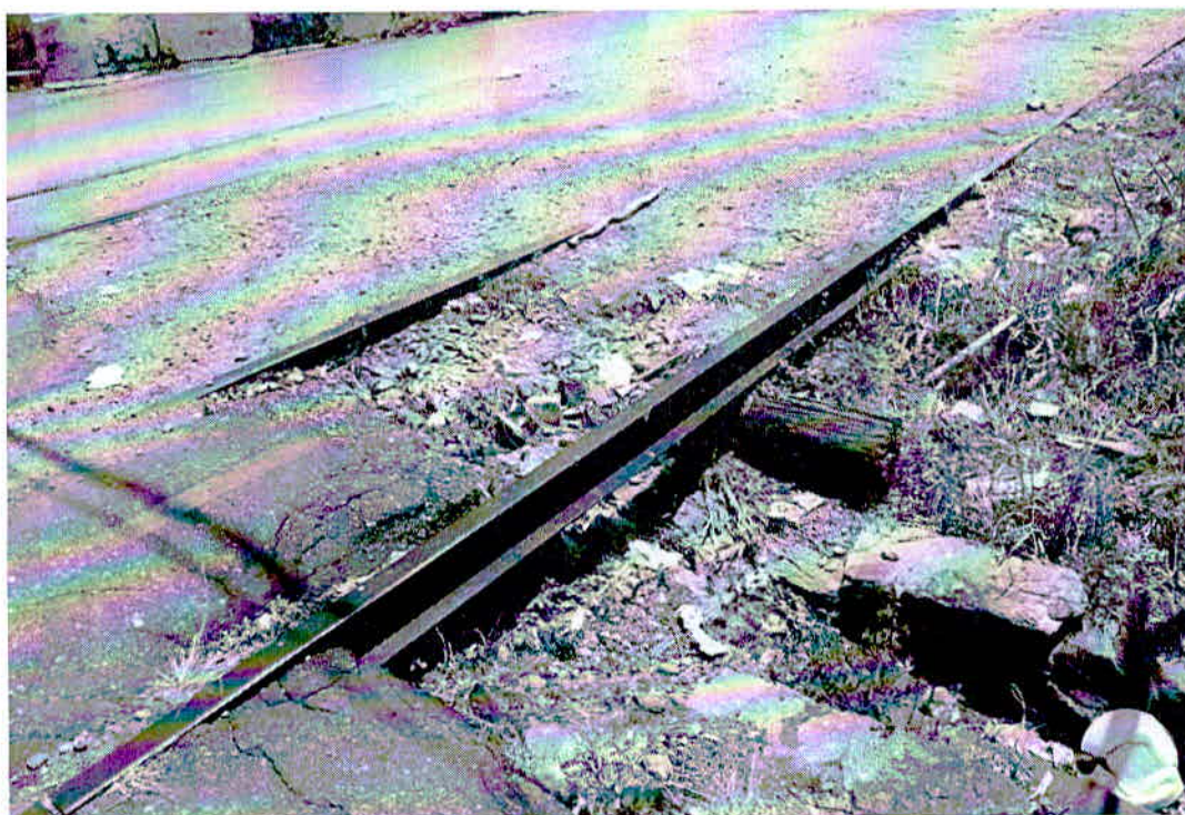
Situação atual dos trilhos. Foto Andreza Tavares.
