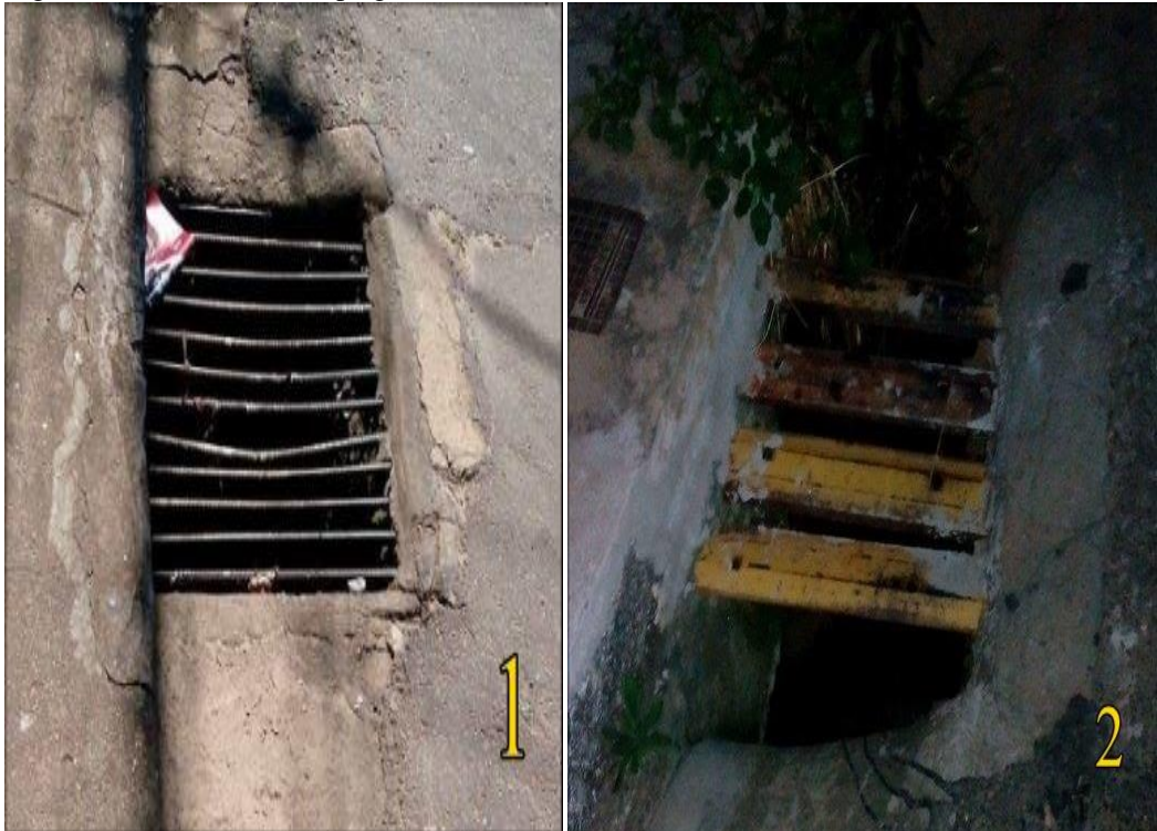
Figura 15 - Bocas de lobo tipo grelha
