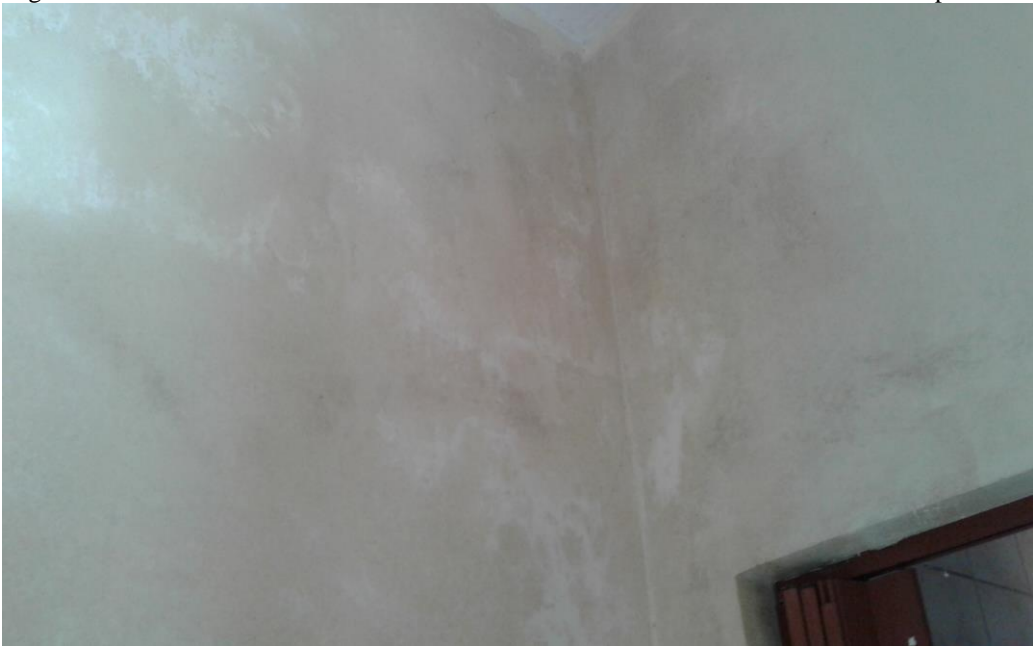
Figura 29 - Parede interna de muro de arrimo com manchas decorrentes de ascensão capilar 2
