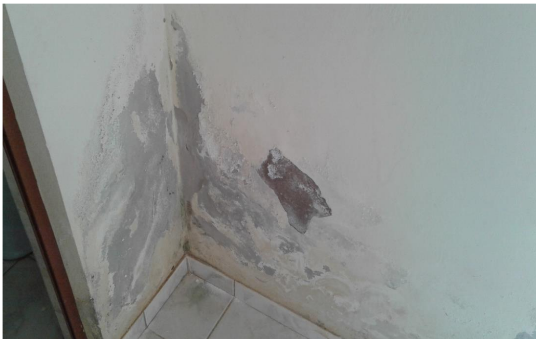
Figura 31 - Parede interna de residência com descolamento do substrato
