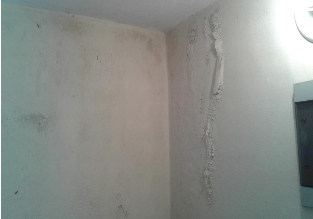
Figura 30 - Parede interna de muro de arrimo com manchas e descolamento da pintura decorrente de ascensão capilar.
