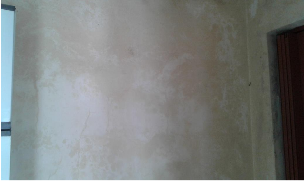
Figura 28 - Parede interna de muro de arrimo com manchas decorrentes de ascensão capilar 1
