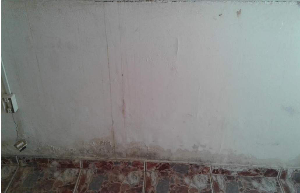
Figura 32 - Parede interna de residência com início de bolor e degradação da pintura
