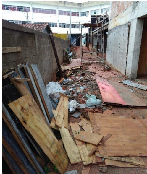
Figura 33: Obstrução das vias no canteiro de obras.
