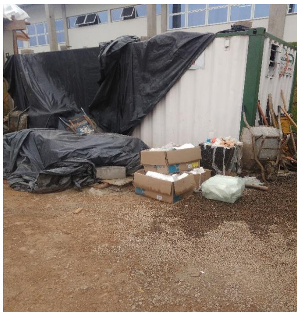
Figura 56: Falta de organização no canteiro de obras.
