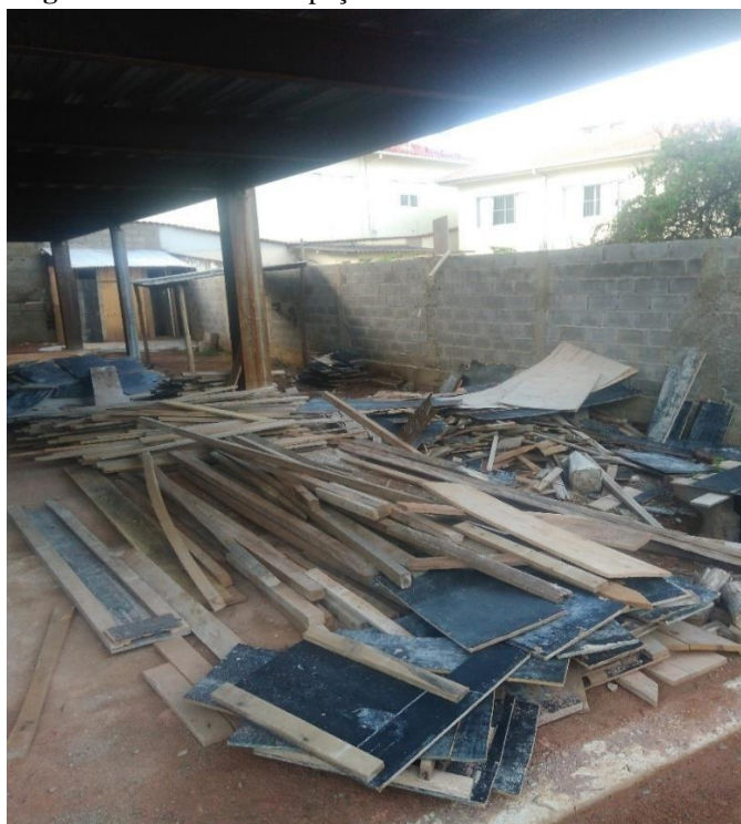
Figura 14: Acúmulo de peças de madeira não utilizadas na obra.
