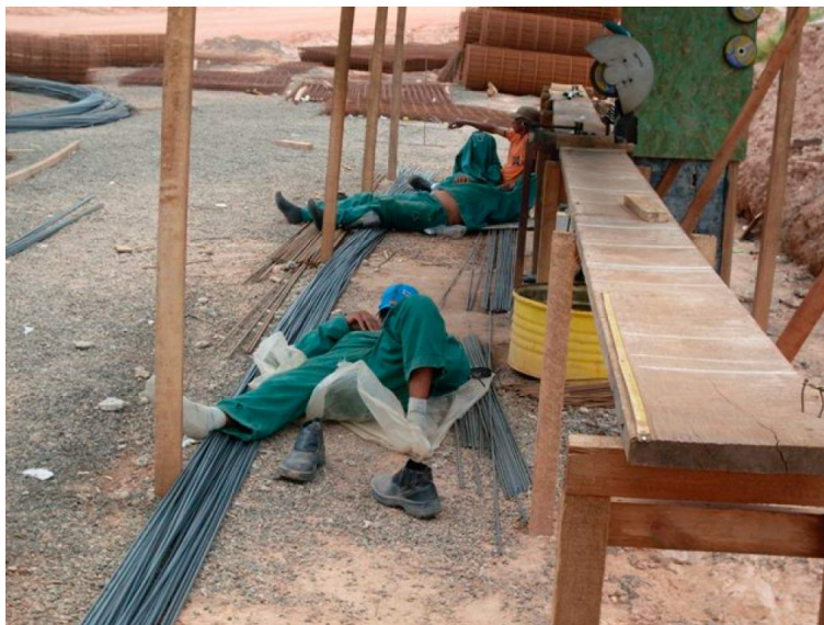
Figura 41: Improvisação de local de descanso no canteiro de obras.
