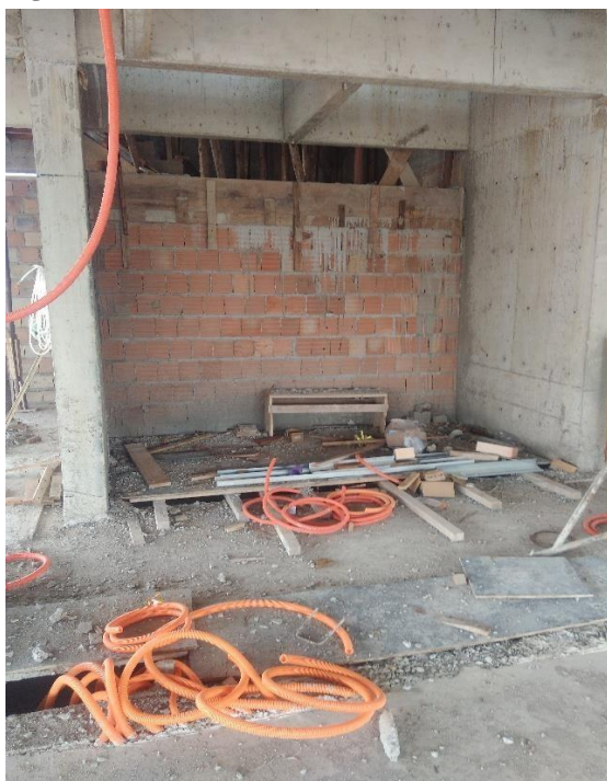
Figura 30: Materiais diversos na caixa de elevador.
