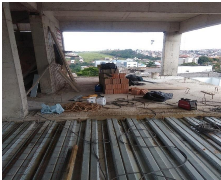
Figura 18: Estocagem de tijolos cerâmicos feita de maneira incorreta.
