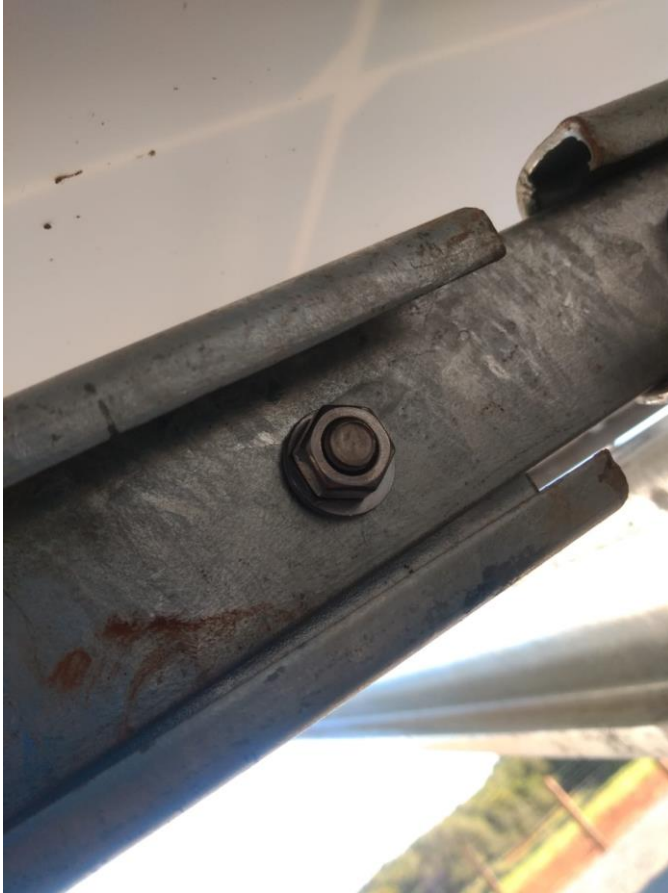
Figura 26 – Distanciamento indevido comprometendo a resistência mecânica
