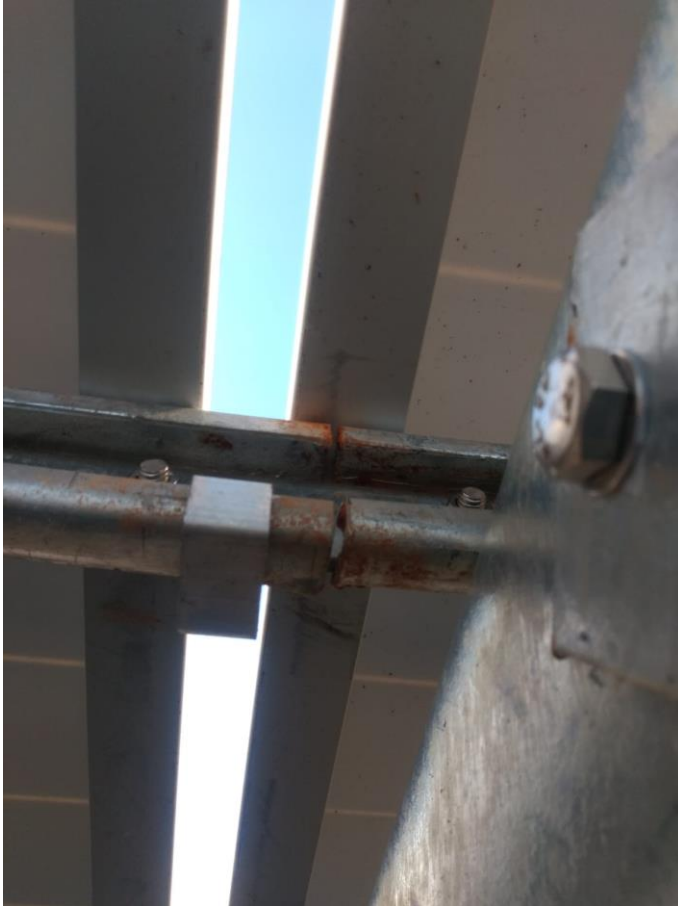
Figura 22 – Junção fora do longitudinal e com sinais de corrosão
