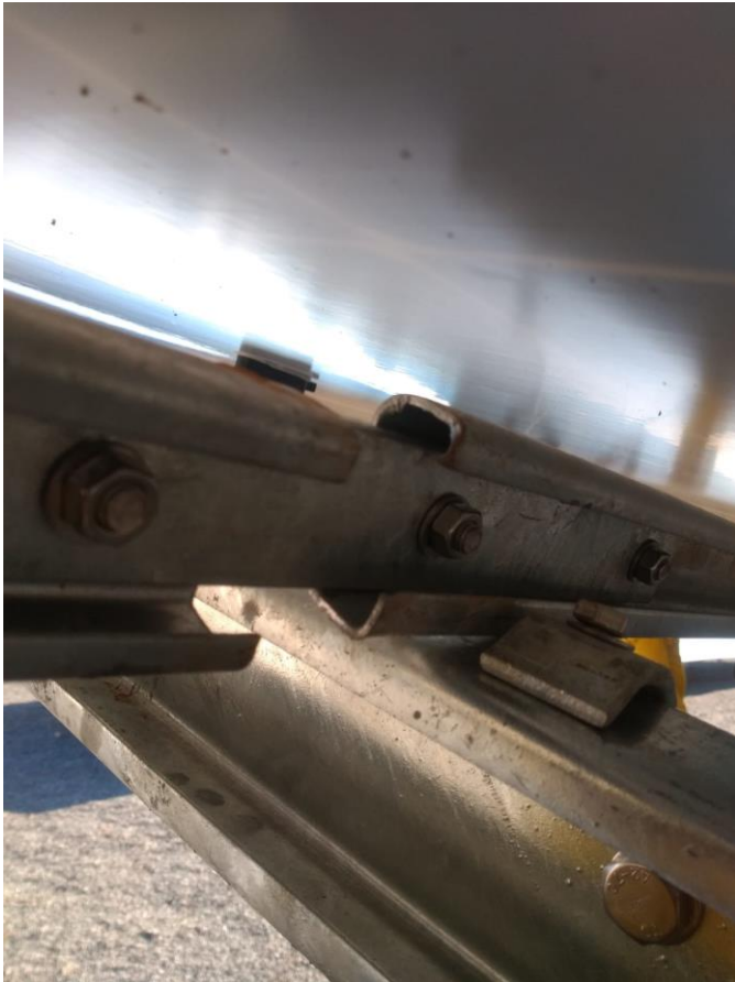
Figura 27 – Distanciamento indevido comprometendo a resistência mecânica e sem o grampo de fixação
