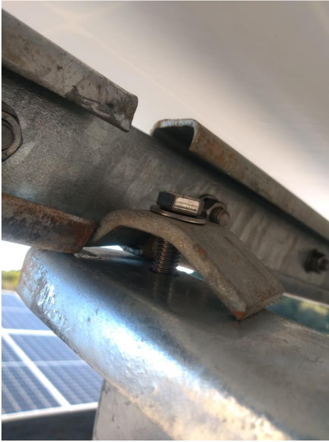
Figura 21 – Grampo de fixação no lugar indevido
