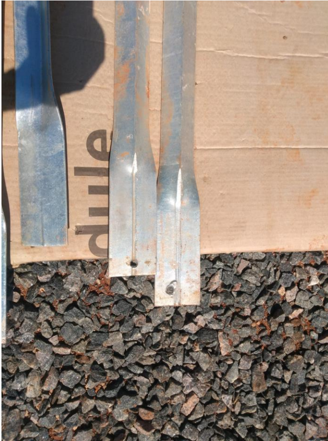
Figura 14 – Falhas por conta da galvanização
