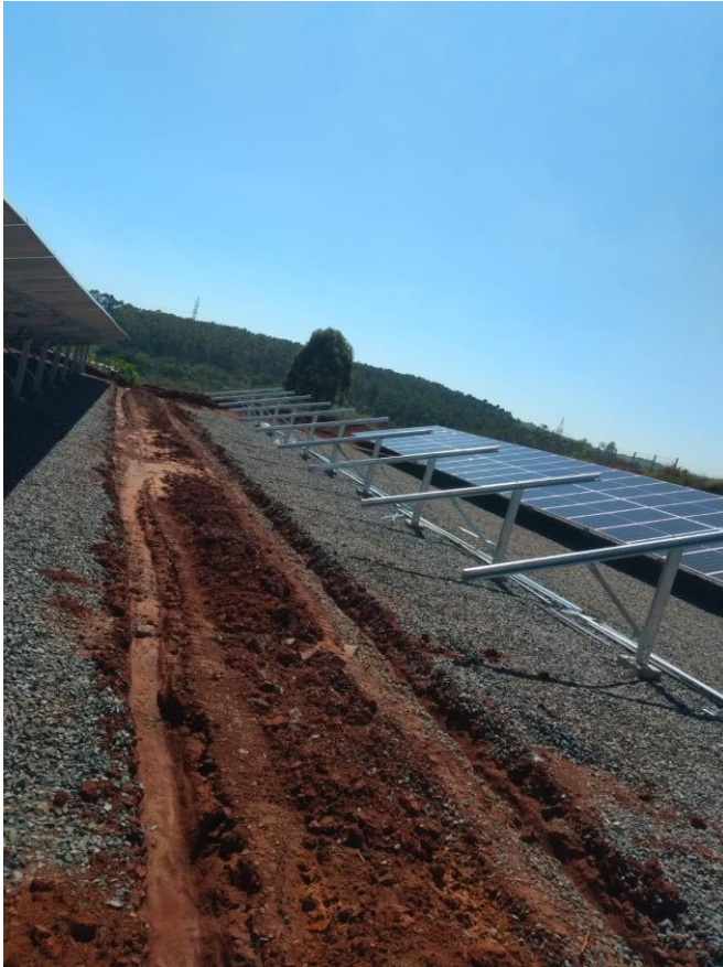
Figura 17 – Estrutura não finalizadas por contas das mãos francesas com falhas
