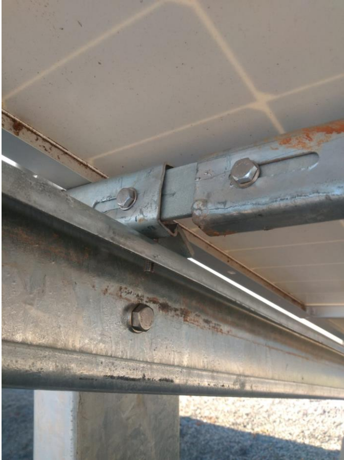
Figura 23 – Junção fora do longitudinal e os trilhos com espaçamento maior que o correto
