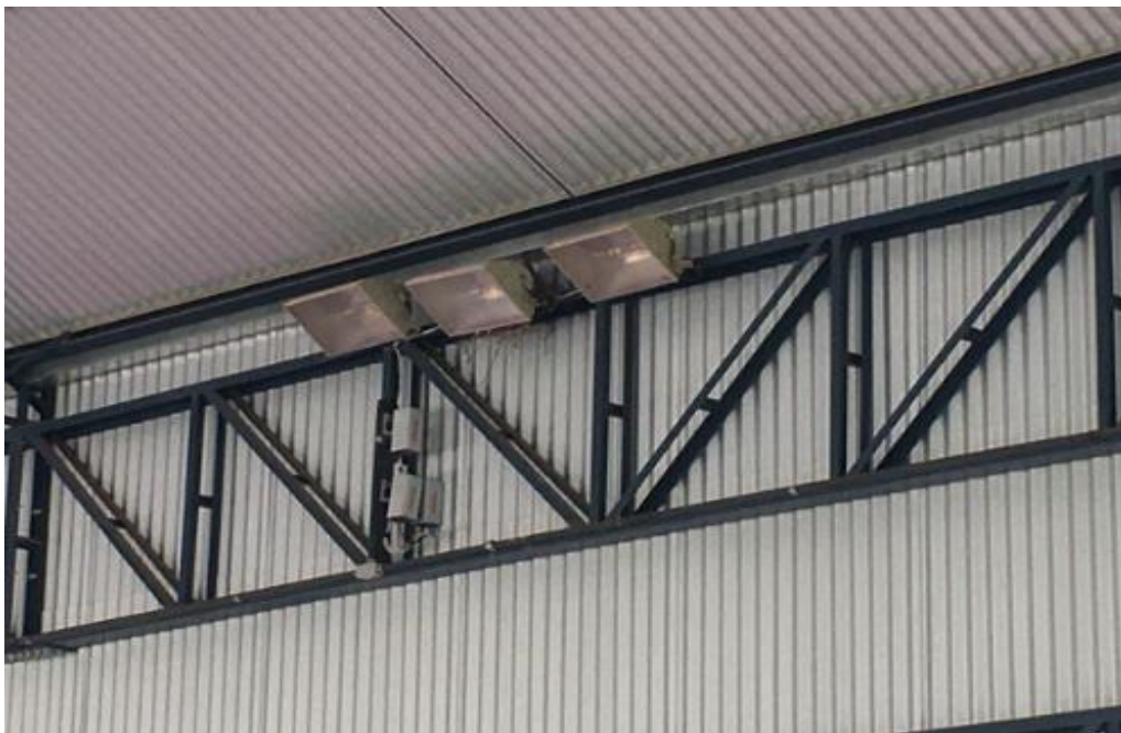
Figura 13 - Distribuição incorreta dos refletores.
