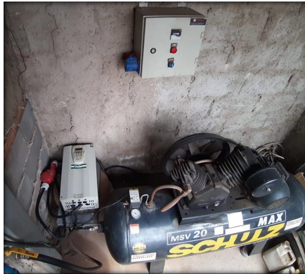
Figura 29 - Compressor e inversor de frequência.
