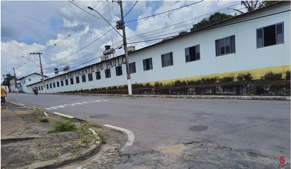
Figura 65 – desnível existente na calçada da fachada principal
