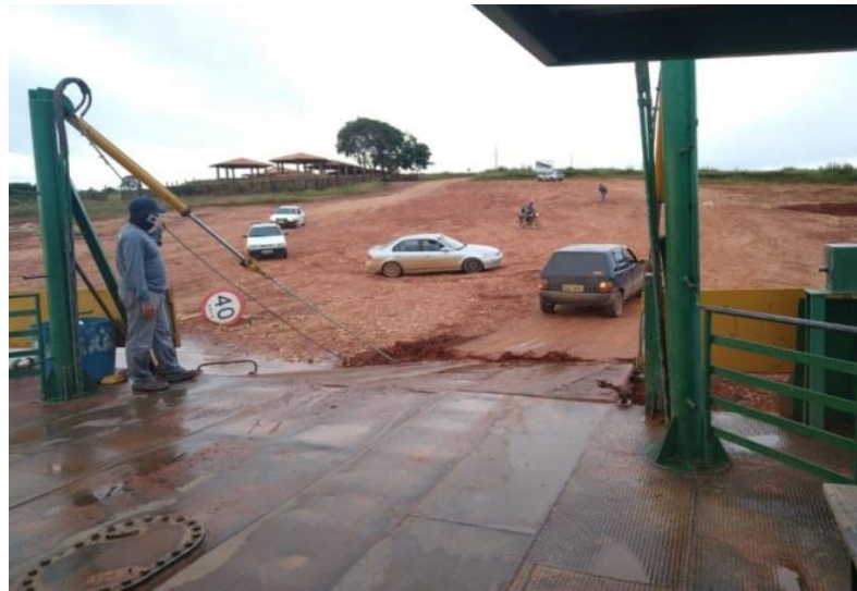
Foto 6- Falta de calçamento adequado na entrada da balsa. (Porto lado da comunidade de Araúna)
