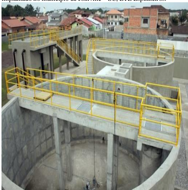
Figura 17- Sistema com reator uasb seguido por filtro anaeróbio implantado no município de Joinville – SC, ETE Espinheiros.
