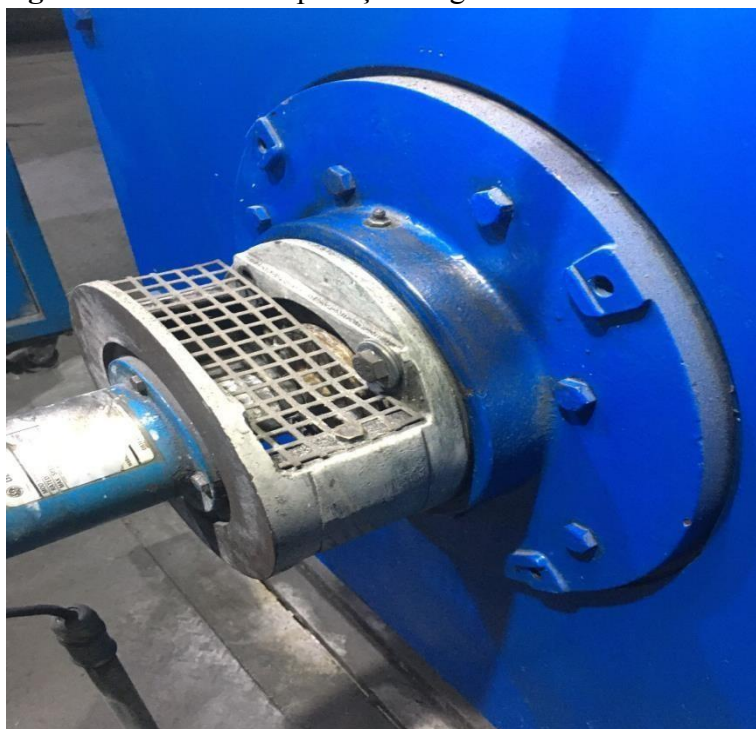
Figura 05 – Local de aplicação da graxa no motor elétrico
