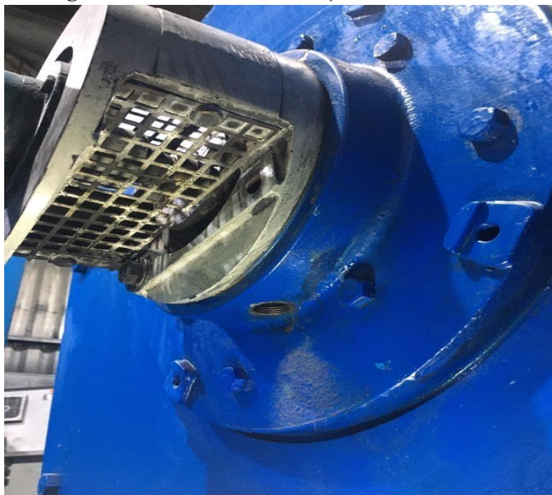
Figura 04 – Dreno de lubrificação do motor elétrico
