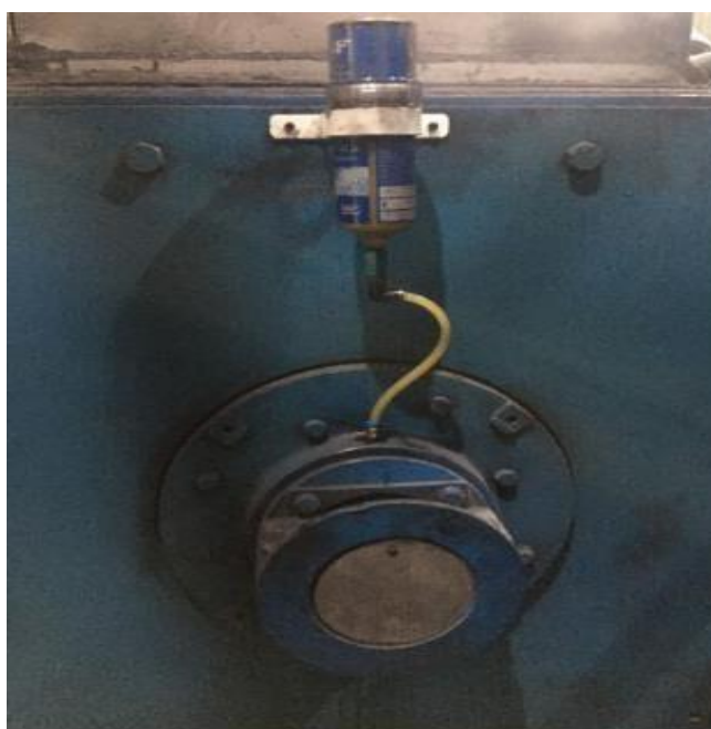
Figura 13 – Lubrificador automático instalado
