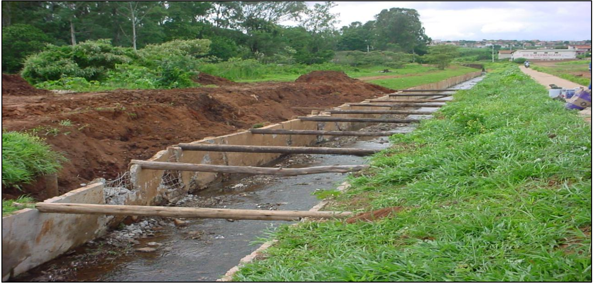
Figura 5- Trecho reconstruído do canal do ribeirão Araras após desabamento
