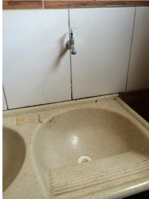
Figura 04 – Torneira do tanque da lavanderia
