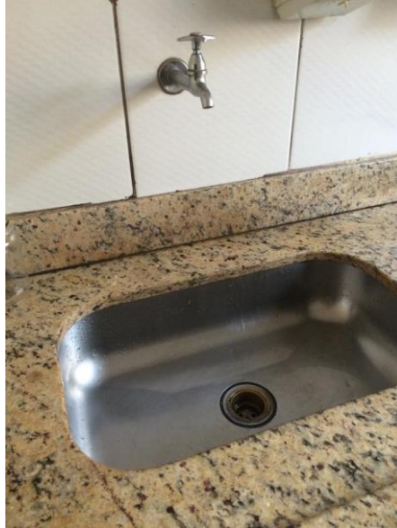
Figura 03 – Torneira da pia da cozinha
