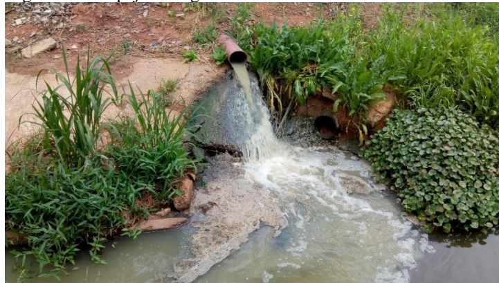
Figura 36. Despejo de esgoto residencial direto no Ribeirão Jardim
