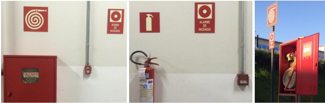
Figura 47 – Sinalização de emergência.
