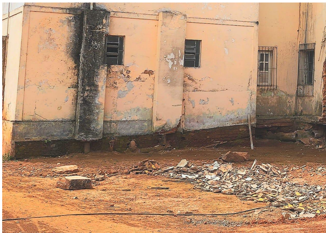
Figura 8 - Detalhe Fundação Inexistente
