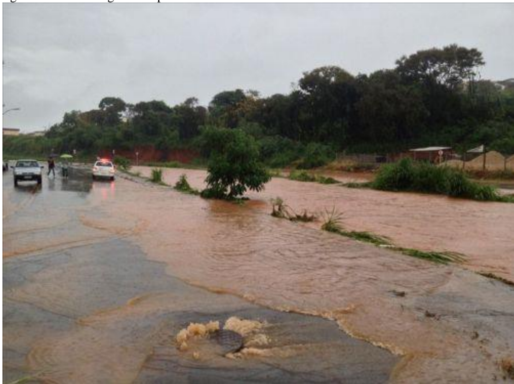
Figura 23 – Ruas alagadas no ponto 13
