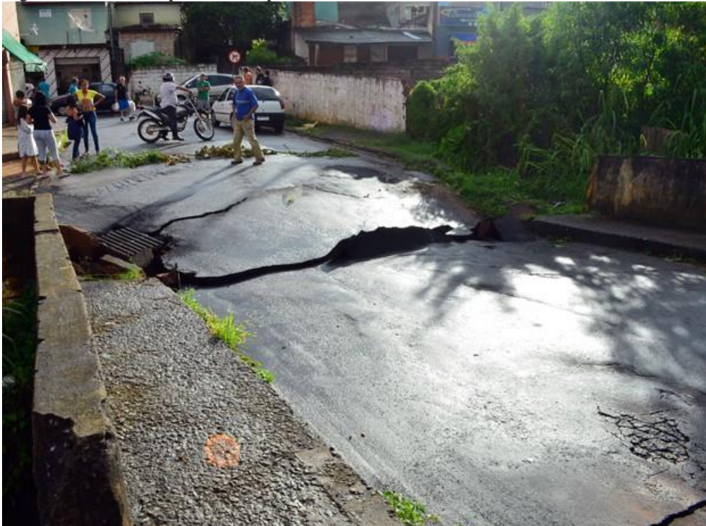
Figura 21 – Ponte rompida entre os pontos 11 e 12
