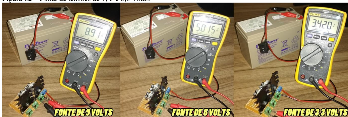
Figura 62 – Fonte de tensões de 9, 5 e 3,3 Volts.
