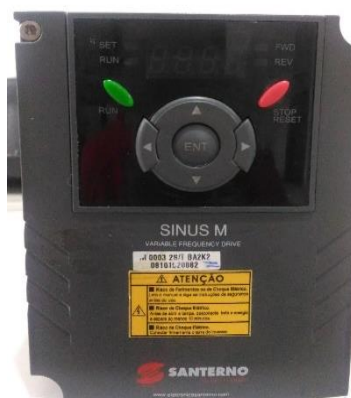
Figura 17: Painel elétrico (inversor de frequência)
