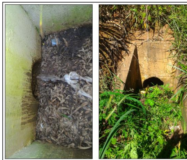
Figura 03 - BSTC Ø=0,40 m (est. 344+14,84 PD) com caixa à montante e ala à jusante ligeiramente assoreada
