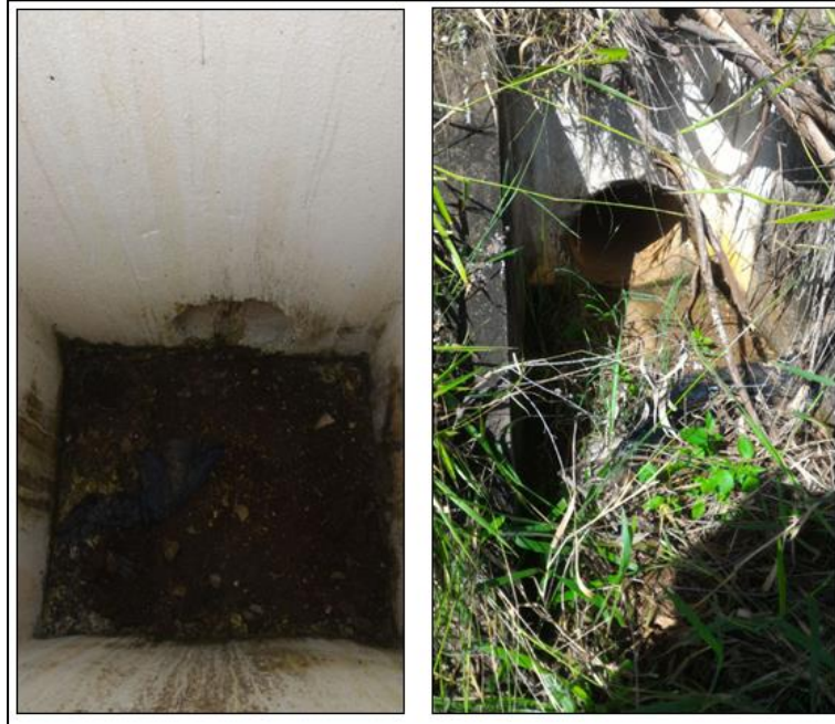
Figura 04 - BSTC \varnothing=0,40\text{m} (est. 348+16,32 PD) com caixa à montante e ala à jusante desobstruída.
