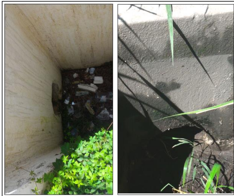
Figura 05 - BSTC \varnothing=0,40\text{m} (est. 361+1,38 PD) com caixa à montante em condições de trabalho ala à jusante assoreada, necessitando de limpeza.
