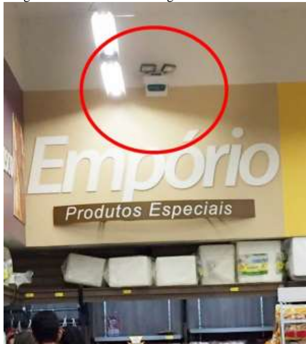
Figura 6. Luminária de emergência na área de vendas
