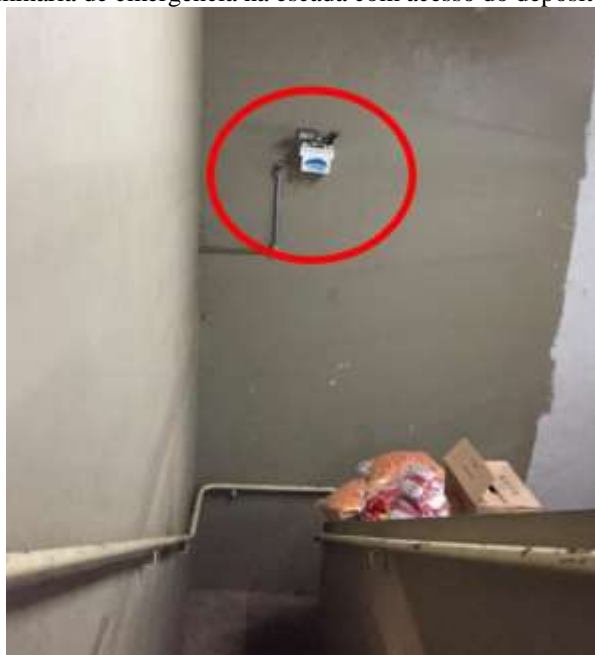
Figura 9. Luminária de emergência na escada com acesso do depósito ao mezanino
