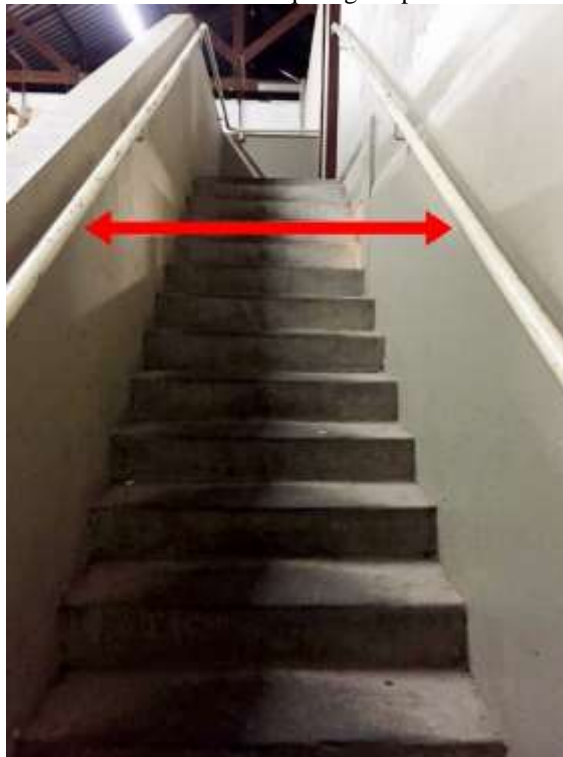
Figura 3. Corrimão na escada que liga depósito aos vestiários
