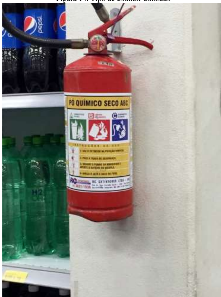
Figura 14. Tipo de extintor utilizado
