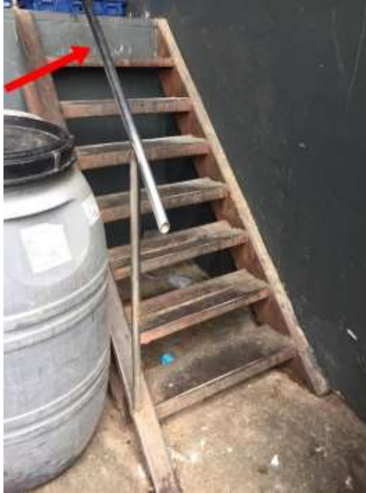
Figura 4. Corrimão na escada que da acesso ao depósito pela área externa
