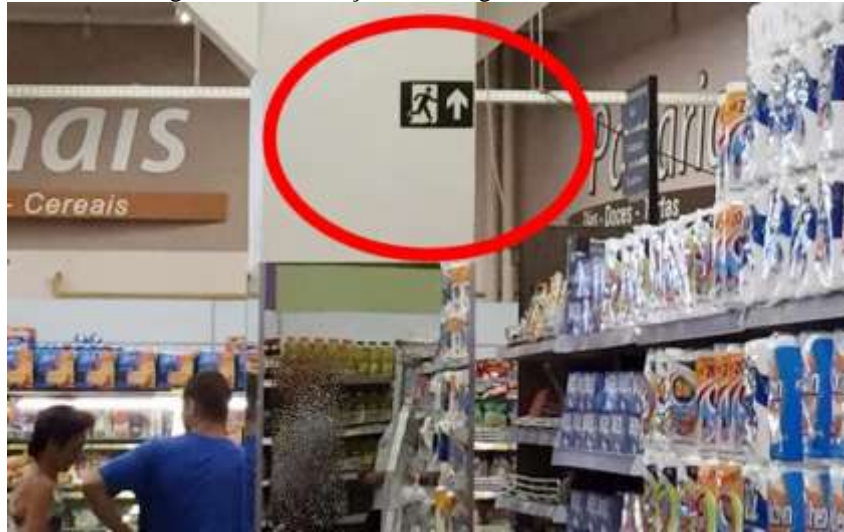
Figura 10. Sinalização de emergência nos corredores
