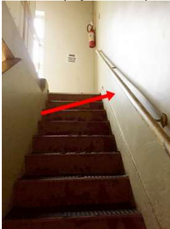
Figura 2. Corrimão na escada que liga área de vendas à parte administrativa
