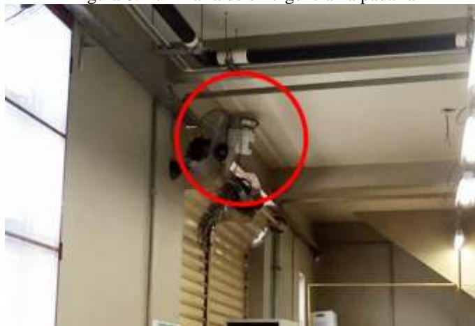
Figura 8. Luminária de emergência na padaria
