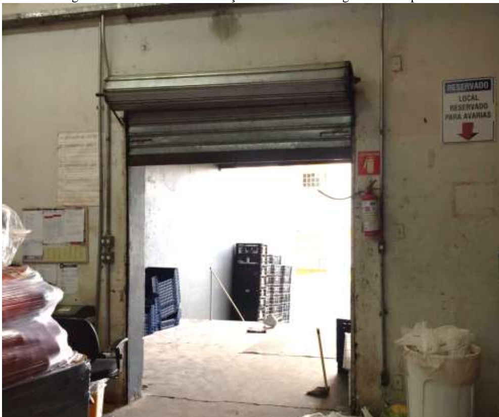
Figura 13. Ausência de sinalização na saída de emergência do depósito
