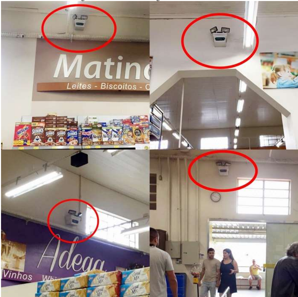
Figura 7. Luminárias de emergência na área de vendas
