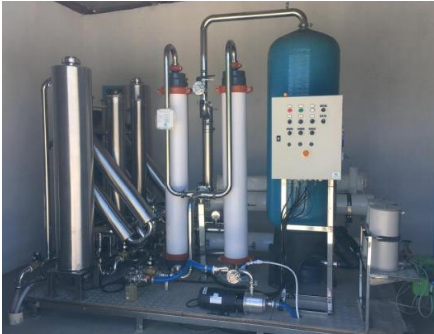
Figura 26 - Estação de Tratamento Compacta
