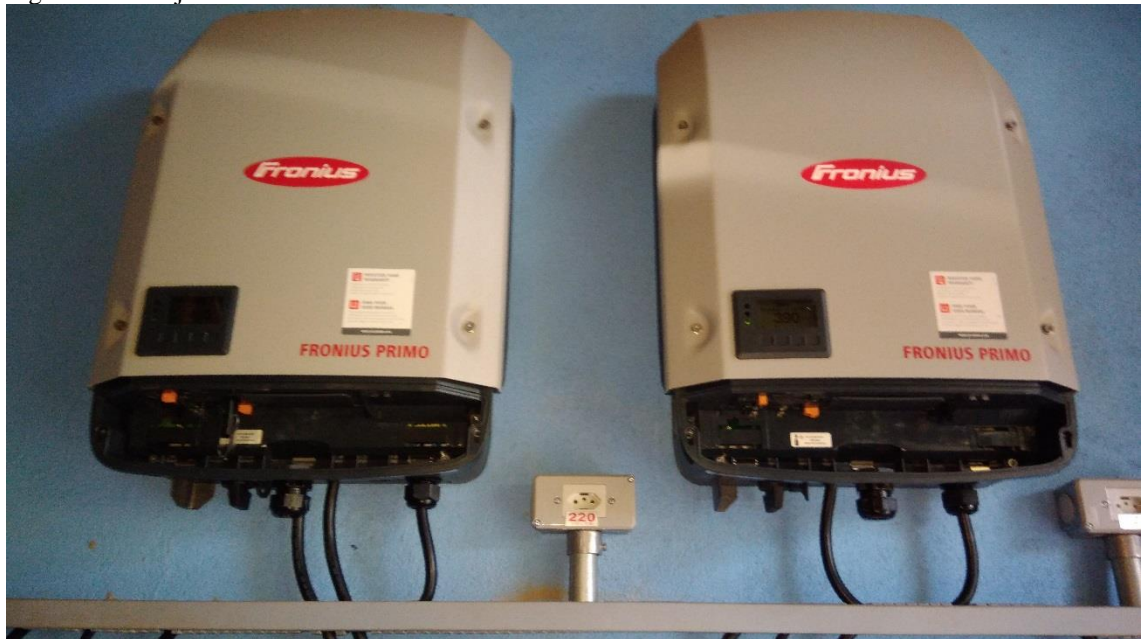
Figura 25 - Conjunto de Inversores Fronius.
