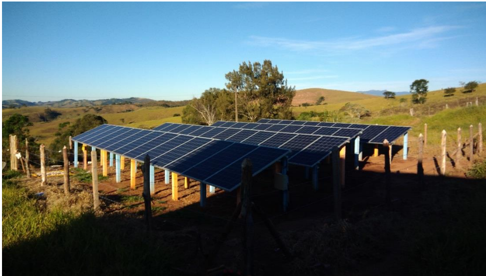
Figura 27 - Disposição dos painéis fotovoltaicos.
