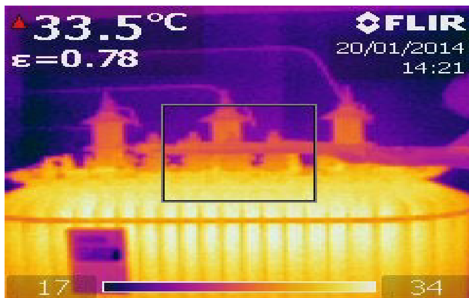
Figura 9: Análise termográfica de um transformador.
