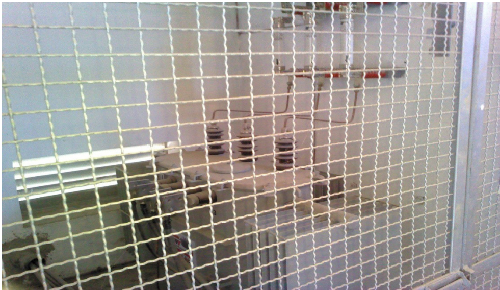
Imagem 4: Transformador de 500 kVA.
