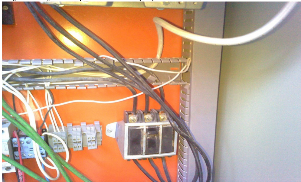
Imagem 8: Disjuntor do painel de alimentação primária.
