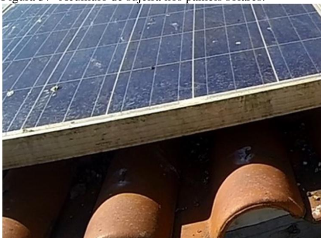
Figura 37- Acúmulo de sujeira nos painéis solares.
