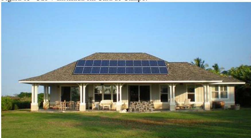
Figura 05- USFV Instalada em Casa de Campo.
