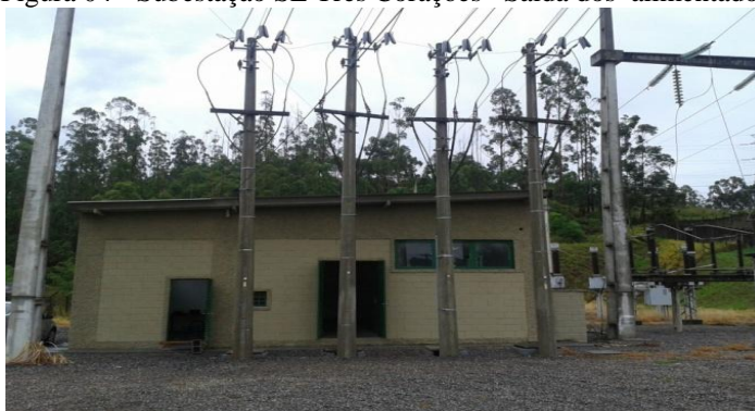
Figura 04 - Subestação SE Três Corações– Saída dos alimentadores
