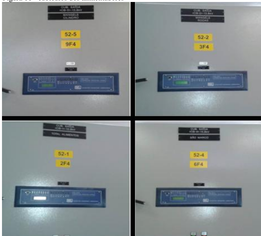
Figura 06 - cubículos dos alimentadores
