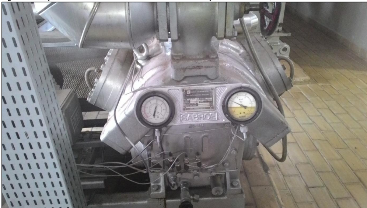
Figura 6. Compressor de amônia sem sistema de controlador de pressão
