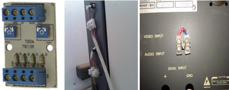
Figura 26 - Placa para amplificar sinal vindo dos transmissores
