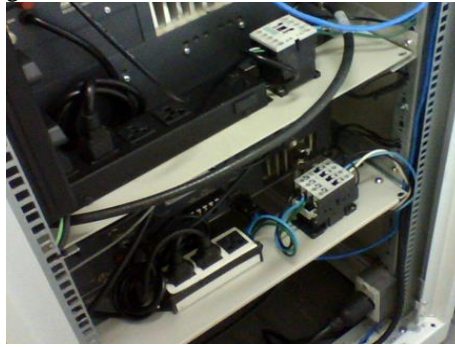
Figura 31- Filtro de linha e contator dos transmissores
