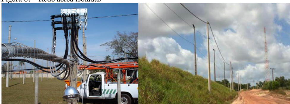
Figura 07 - Rede aérea isoladas
