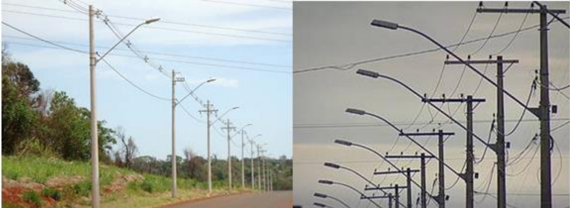
Figura 04 - Redes de distribuição aérea - RDA
